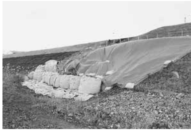
令和3年8月の増水で崩れた堤防 (酒倉一色地内)
