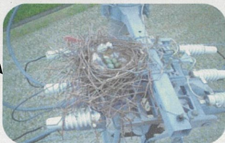
○電柱上部の開閉器の上
