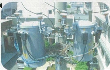
○電柱中間部の変圧器の間
